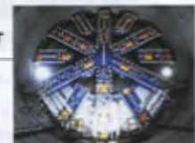
▲第一貫通圏トンネル（北品川工区）掘削に向け設置されたシールドマシン
