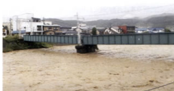
▲横川橋梁の被災直後の様子(宮木～辰野駅間)
