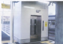
▲ホームエレベーター
