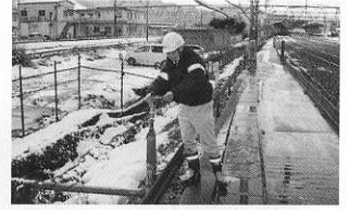
▲スプリンクラーの点検・調整
